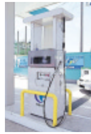
天然ガスの供給機。 府内15か所に設置されています。
